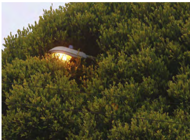
Överväxt gatuarmatur, tänk på att kontinuerligt sköta om belysning och vegetation.
